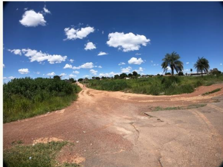
ASFALTO DE BAIXA QUALIDADE AUSÊNCIA DE DRENAGEM E MEIO-FIO AUSÊNCIA DE SINALIZAÇÃO
